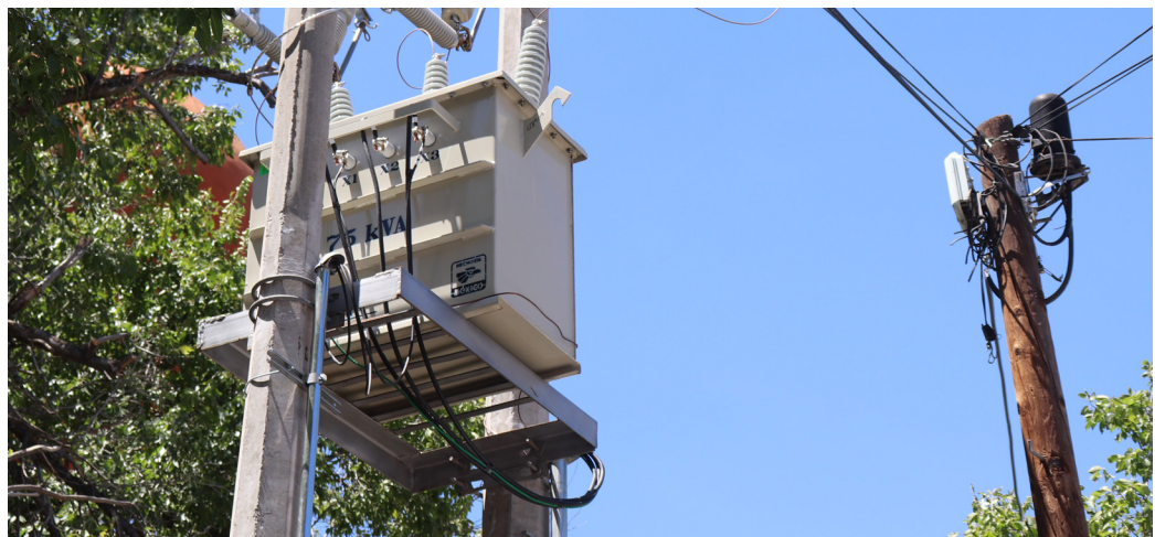
Subestación eléctrica en Preparatoria Álvaro Obregón
