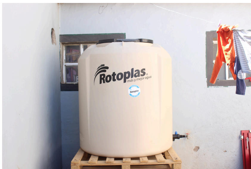
Tinaco instalado sobre mamparas de madera
